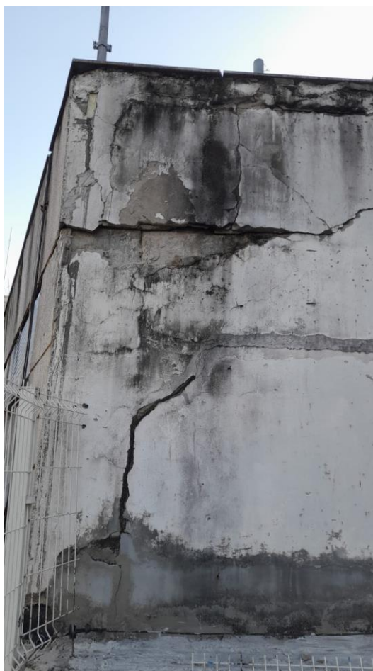
Partes das paredes se soltando
