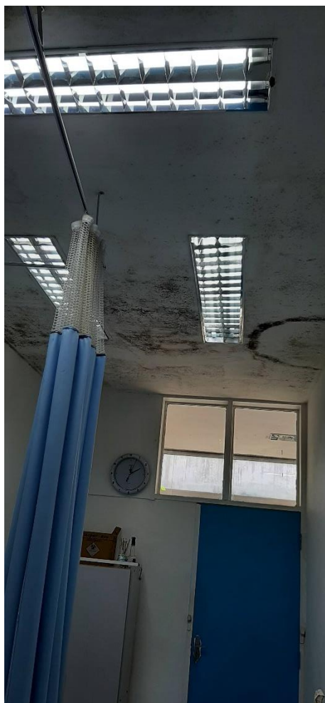
Rebaixamento e pintura deteriorados pela infiltração
