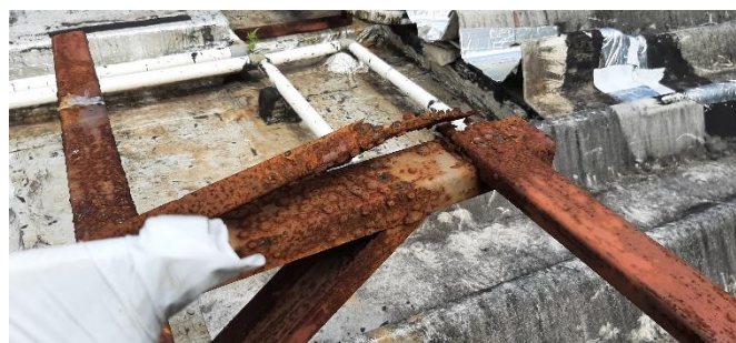
Estrutura metálica deteriorada
