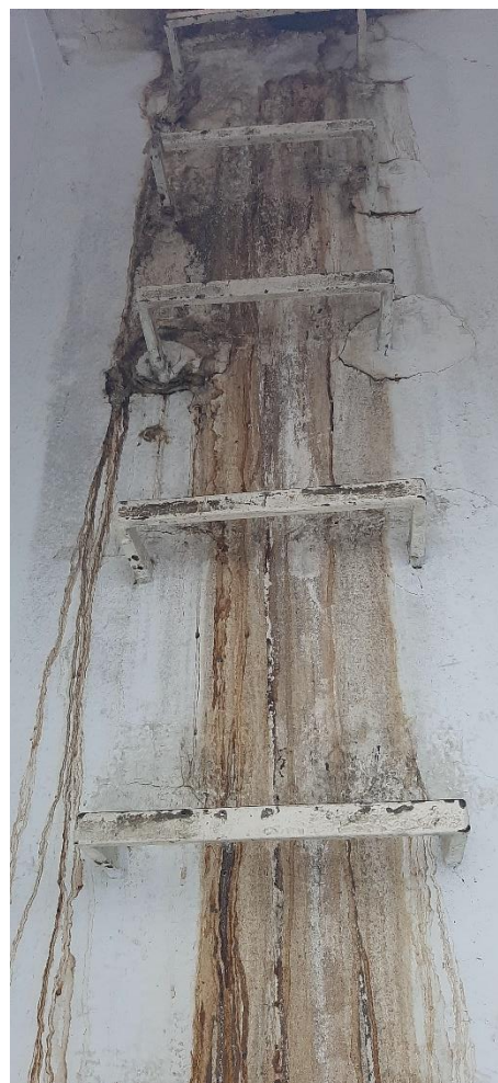
Pintura prejudicada pela infiltração
