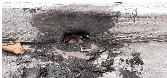
Dreno subdimensionado e entupido
